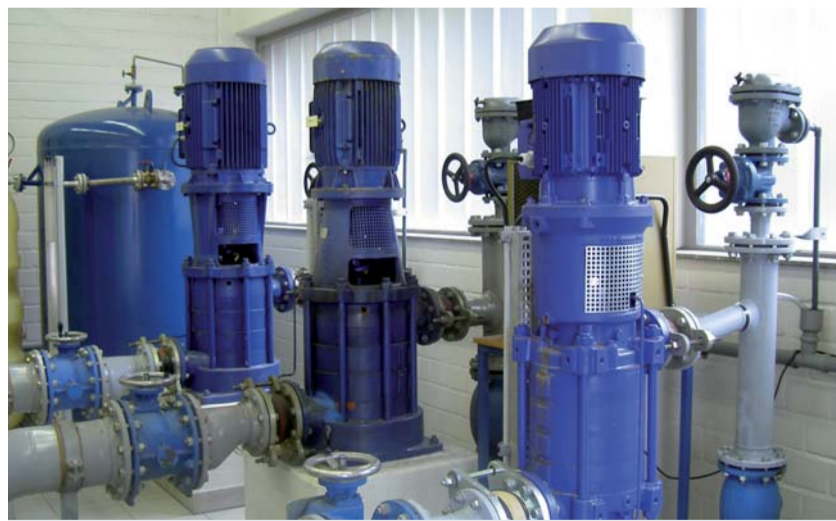
Modernes Pumpwerk an der von-Werner-Straße in Stolberg
